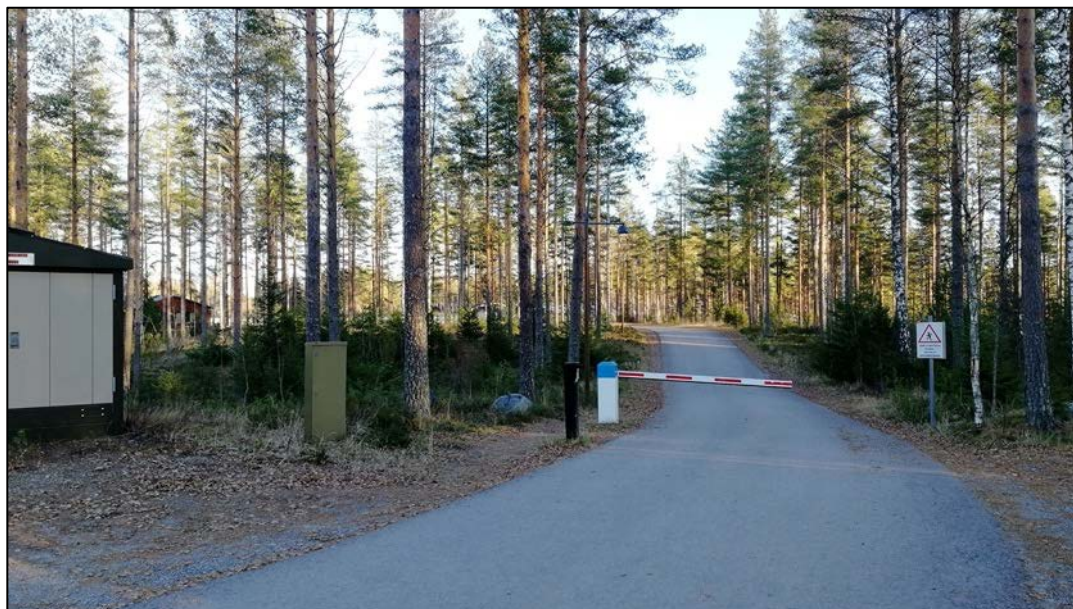
Kuva 2. Rampsintien alkupään puistomuuntamo ja puomi.
