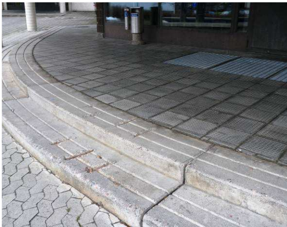
Pääsisäänkäynnin eduslaatoitukseen liittyy elementtirakenteiset ulkoportaat, joissa havaittiin ruosteisia pintateräksiä ja pintalohkeamia.
