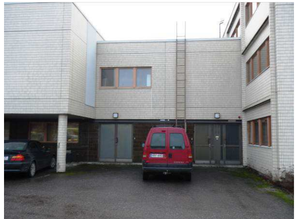
Julkisivuja täydentävistä pilareista on pudonnut joitakin klinkkerilaattoja.
