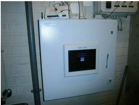
Lämmönsiirtimien säätölaitteet ovat liitettyinä Fixelix-automaatioon, joka kuuluu saatujen tietojen mukaan virastotalolle.
