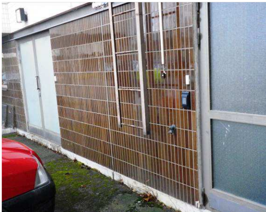
Talotikkaan alapäästä puuttuu vesikatolle asiattomilta kiipeämisen estävä lukittava suojalevy. Tikkaassa havaittiin korroosiota.
