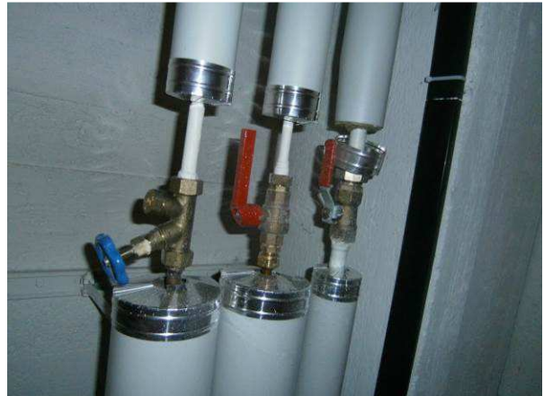
Linjaventtiilit ovat pääosin alkuperäisiä
