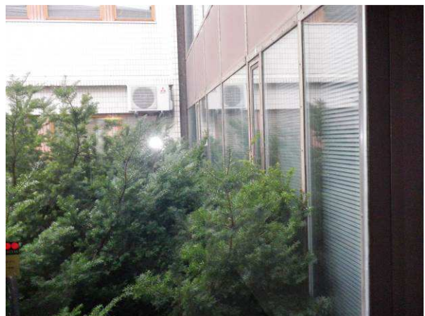
Välikköosan pensaat ja pienet havupuut ovat kasvaneet kiinni rakennukseen.
