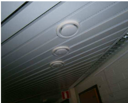
Poistoilman päätelaitteet ovat pääosin kartioventtiilejä
