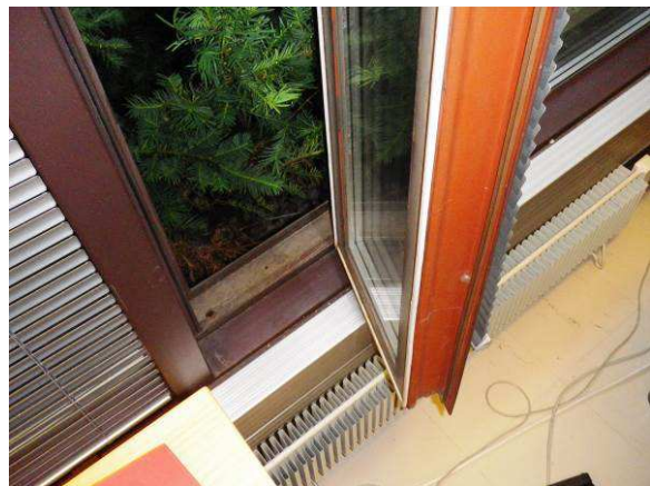
Tuuletusikkunan heloitus jumittaa. (Välikön metalli-ikkuna).
