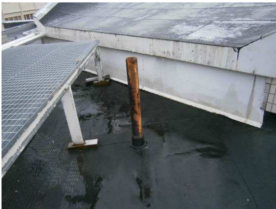
Vesikaton viemärituuletuksiin olisi hyvä lisätä eristys- elementit
