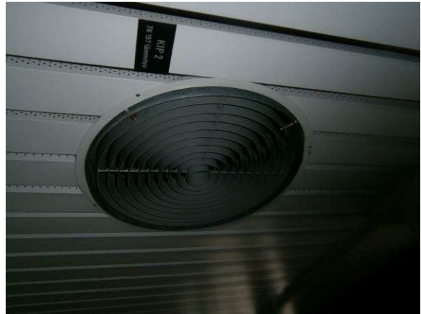
Pääovien luona on alkuperäisiä kiertoilmalämmittimiä
