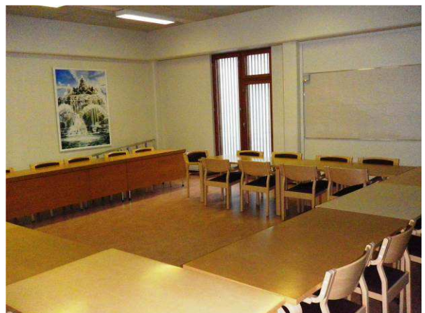
2. kerroksen istuntosalin akustovillalevyistä puuttuu reunalistoituksia. Villakuituja voi irrota sisäilmaan. Riski henkilöturvallisuudelle.
