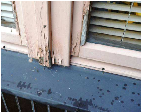
Ikkunoiden ulkopuolen maalipinnat ovat haristuneet. Vesipeltien kaadot ovat loivahkot.
