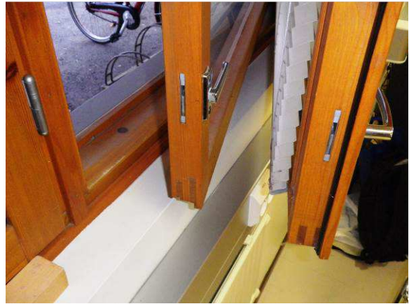
Tuuletusikkuna avattuna. Karmien alaosaan suositellaan asennettavan puuttuva puiteliu'ut.
