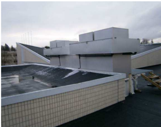
Katolla ei havaittu saattolämmityskaapeleita
