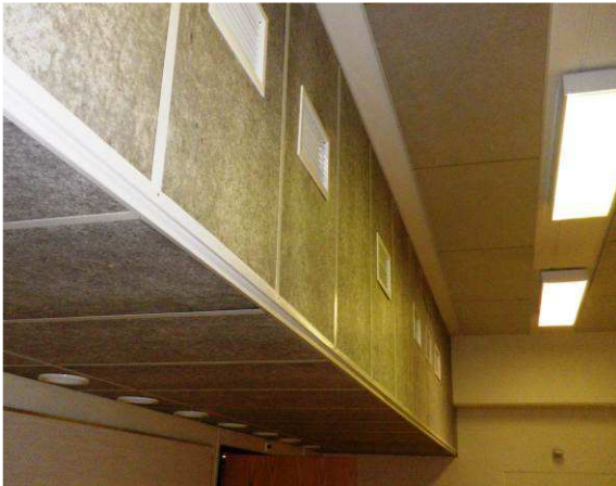
Istuntosalin takaosan iv-kanavisto on verhottu akustovillalevyillä. Sisäilmaan irtoa tuloilman mukana helpommin villakuituja.
