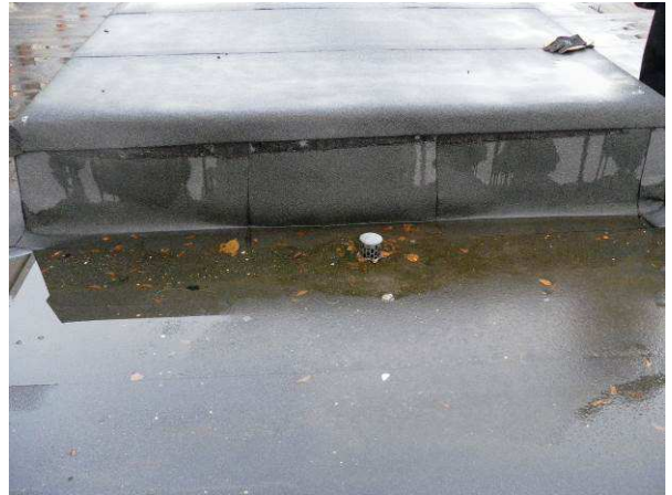
Tämä kattokaivo tulee puhdistaa.
