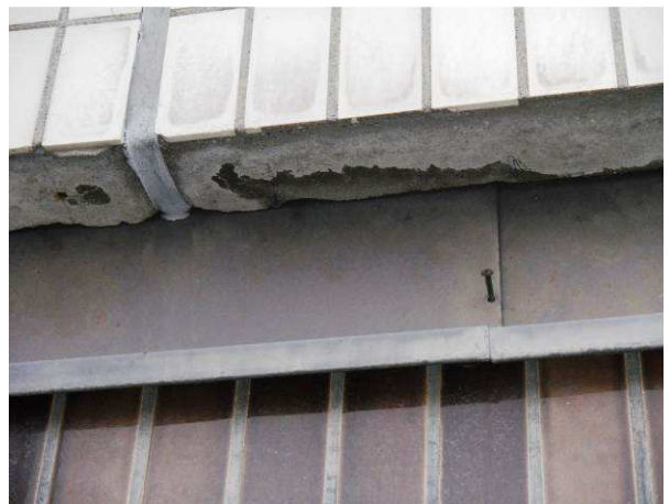
Ulkoseinän pellityksen kiinnike on koholla. Korja- taan puute. Elementin alareunassa
