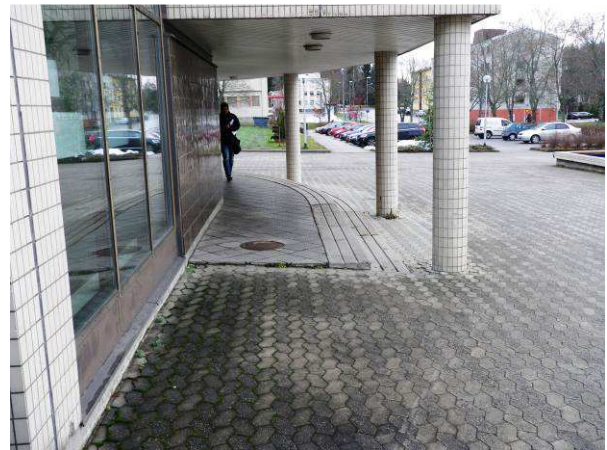
Vähäisiä painanteita havaittiin edustan sidekivetyksissä.
