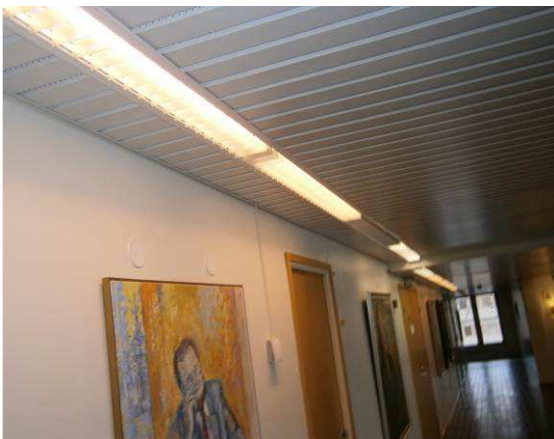
Eri värilämpötilan loisteputkia ja palanut loisteputki
