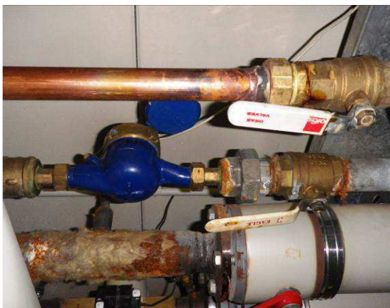
Lämmönjakohuoneessa oleva vesimittari.
