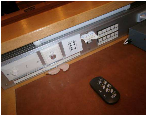
Valtuustosalin osittain uusitut ohjaukset
