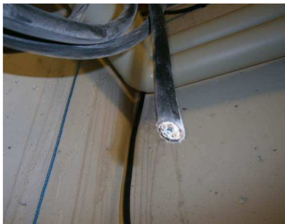
IV-konehuoneessa havaittu päättämätön kaapeli
