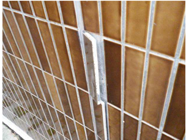
Laattoja on irtoamassa pinnoista, saumakohtis- sa ja elementtien reuna-alueilla eniten.
