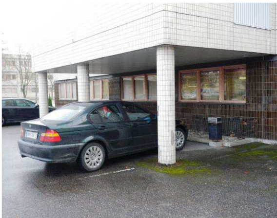
Takasivun asfalttipäällysteissä havaittiin vähäisiä painanteita ja halkeamia.
