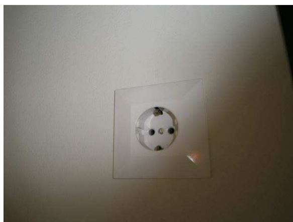
Alkuperäinen maadoitettu pistorasia
