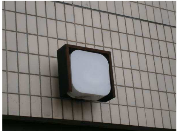
Seinävalaisimen kehys on ruostunut.
