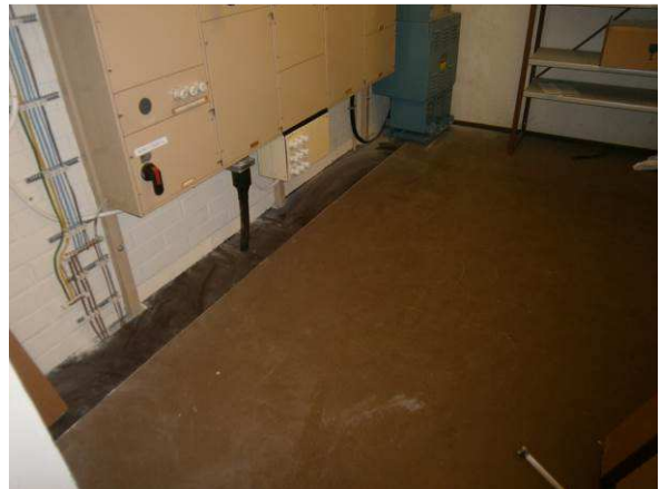
Sähköpääkeskuksen lattia tulee olla suojaeristetty
