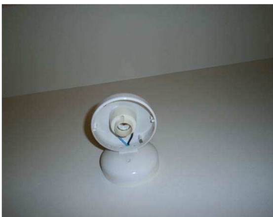
Poistumisvalosta puuttuu lamppu ja lampunkupu
