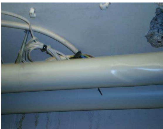
Päättämätön kaapeli lämmönjakohuoneessa
