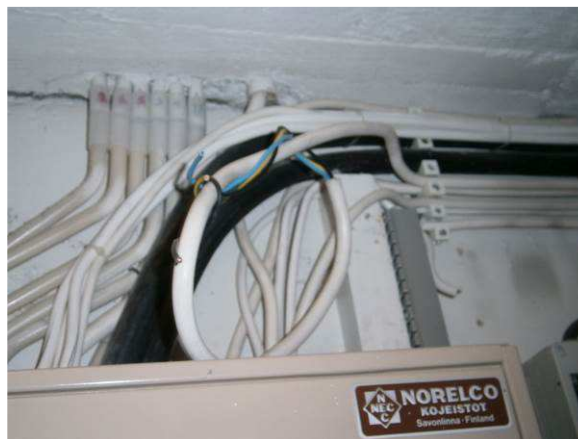
Suihkulähteen ohjauksen vieressä havaittiin päättämättömiä MMJ-kaapeleita
