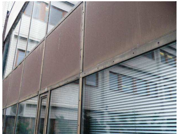
Metalli-ikkunoihin liittyvissä teräslevyissä ja ulko- listoissa havaittiin korroosiota.
