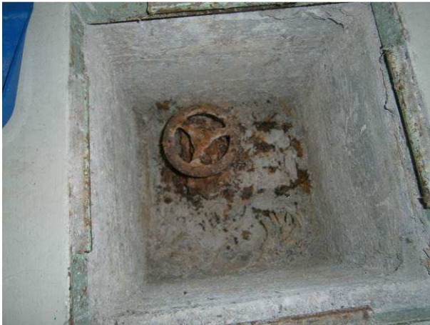
Väestönsuojan sulkuventtiiliä olisi hyvä ajoittain koestaa, nyt oli jumissa
