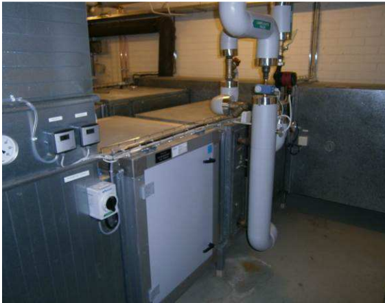
Tuloilmakoneiden puhaltimet ja säätölaitteet ovat uusittu
