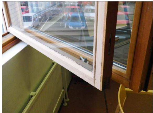
Ulkopuolen pinnat ovat maalattu ulkopuolelta ikkunoiden ollessa kiinni, maaliraja näkyy ulkopuitteessa.
