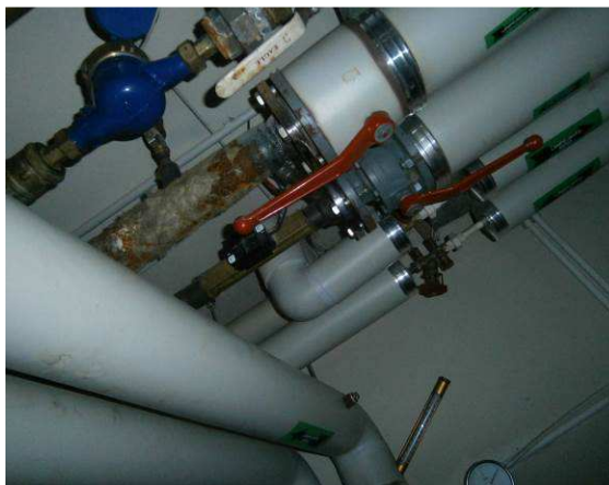
Valtuustotalolle lähtevät vesijohdot ja valtuustotalon kylmänveden mittaus
