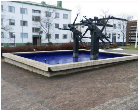
Edustalla olevan vesialtaan reunalaatoituksissa havaittiin vaurioita.
