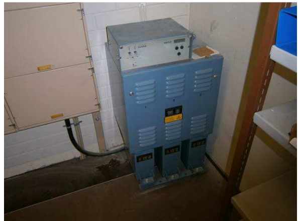
Alkuperäinen kompensointikojeisto pitää ääntä.
