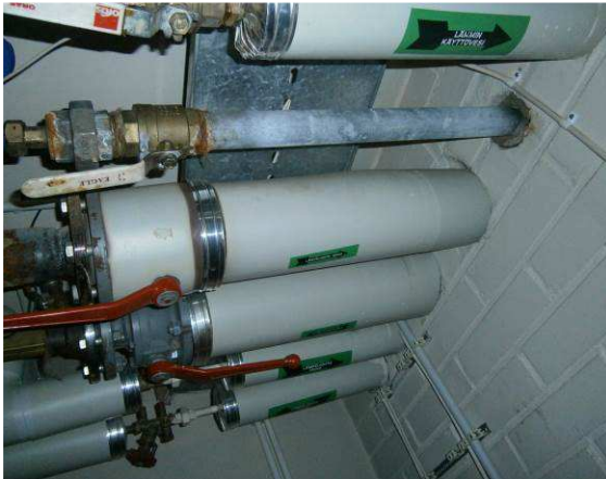
Lämmönjakohuoneelta lähtevä kylmänveden runkolinja on sinkitty teräsputkea
