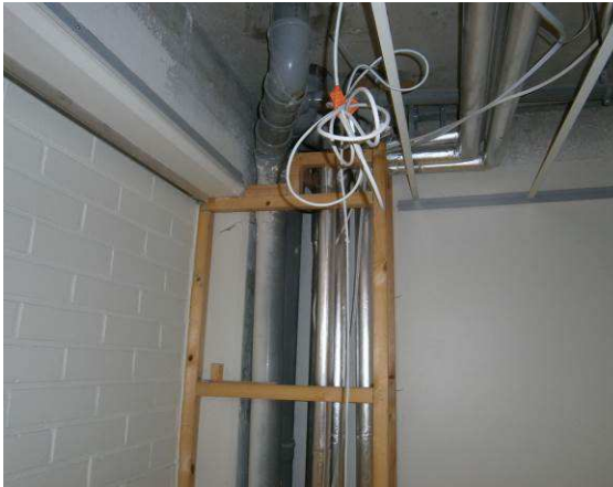
1.kerrosn putkihormi avattu vesivuodon vuoksi
