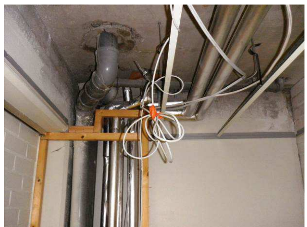
2. kerroksen vesivahingon (syksy 2014) jälkeen 1. kerroksen rakenteita on jouduttu purkamaan.
