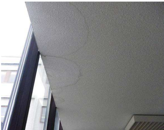
Pinnan kuivuneita kosteusjälkiä sisäportaikossa.
