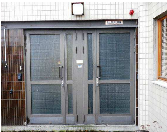
Takaovia, jossa havaittiin vähäistä korroosiota.
