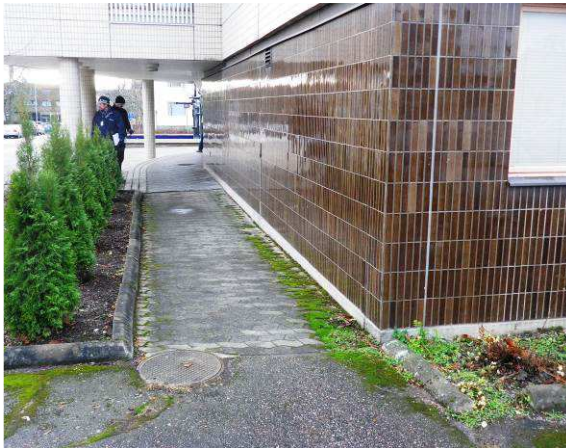
Vierustan kivetys on painunut ja sammaloitunut. Salaojaputkiston tarkastuskaivo rakennuksen nurkalla.
