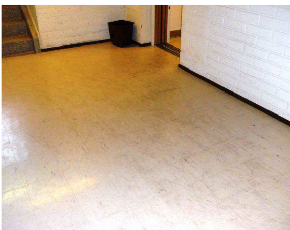
Pohjakerroksen lattialaminaatit ovat kuluneet.
