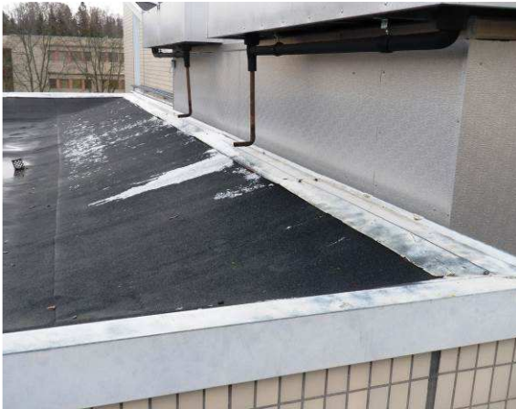
Jäähdytysyksikön lauhdevesien ohjausta.
