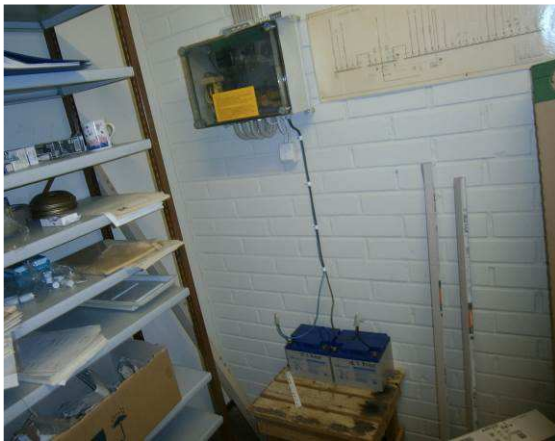
Sähköpääkeskuksessa sijaitsevan laitteiston akut ovat tarkistettu viimeksi vuonna 2005.
