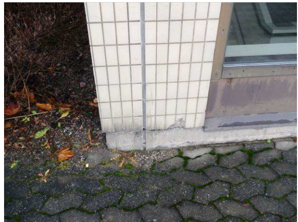
Sokkeleiden saumauksissa havaittiin haristumista.
