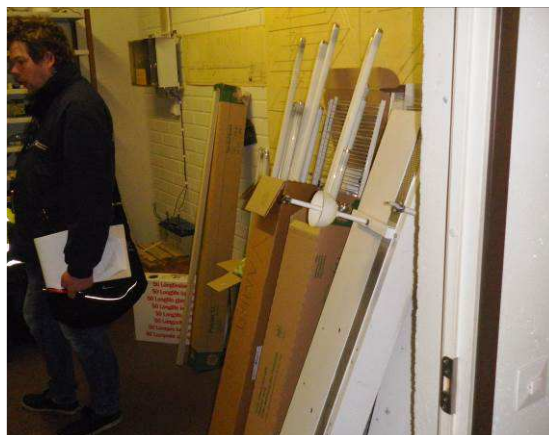
Sähköpääkeskuksessa havaittiin sinne kuulumatonta tavaraa.
