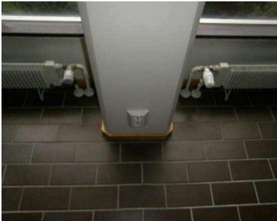
Patteriventtiilit ovat pääosin alkuperäiset, muutamia on uusittu
