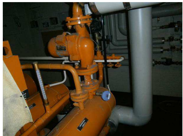
Lämmönjakohuoneen pumput ovat pääosin alkuperäiset
