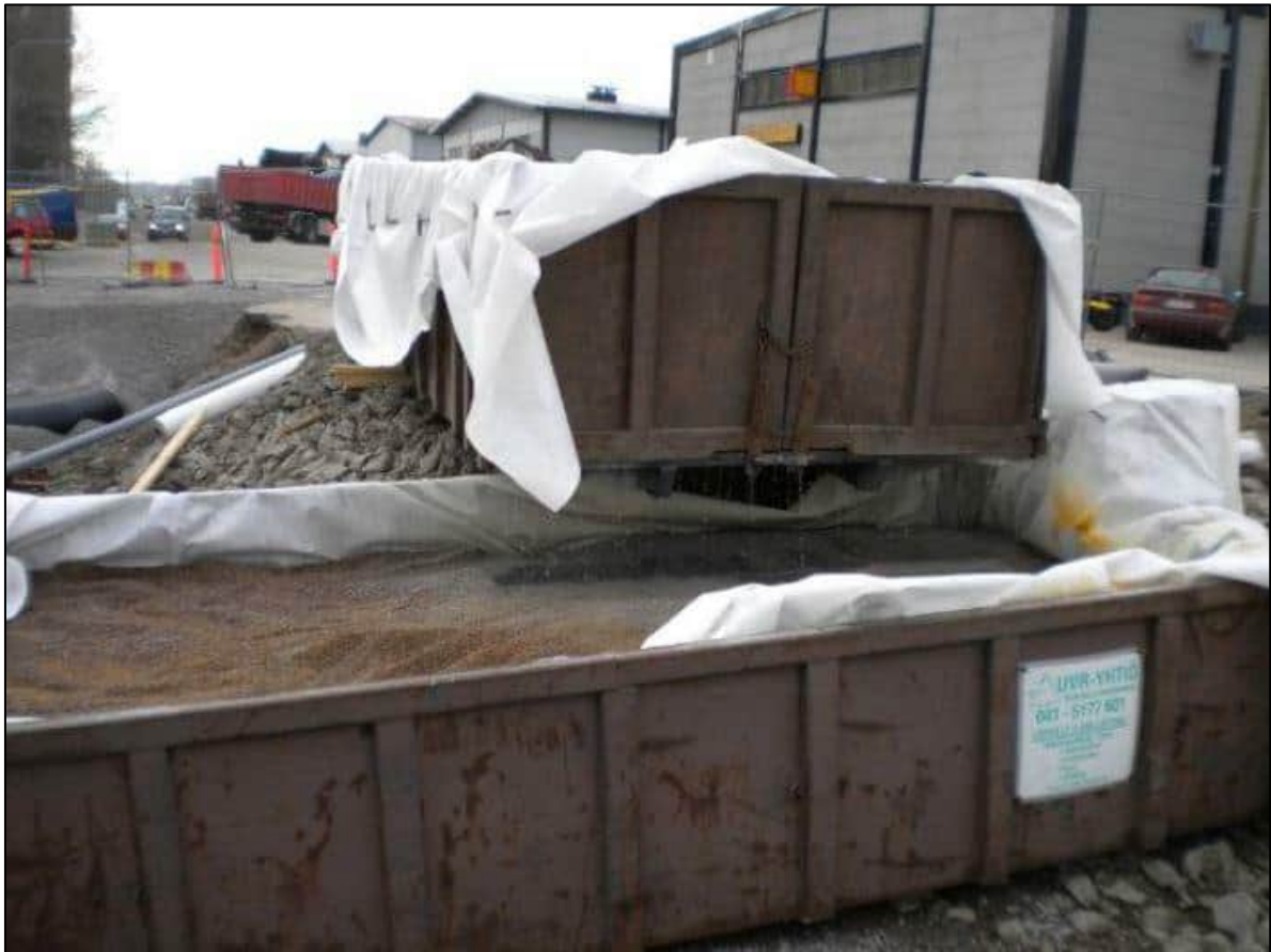
Kuva 13. Esimerkkikuva vaihtolavan sisään rakennetusta suodattimesta. 4
