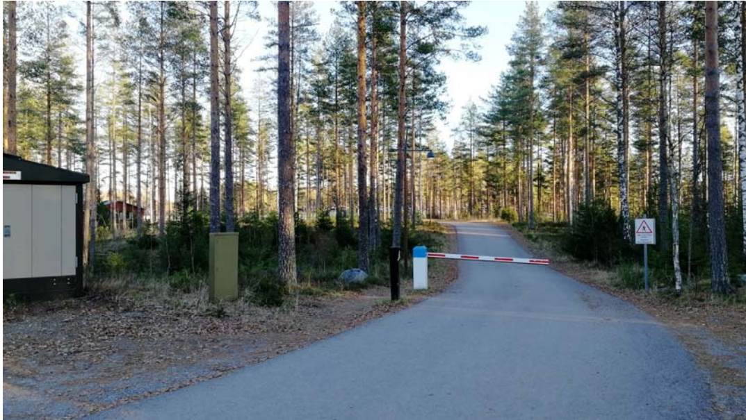
Rampsintien alkupään puistomuuntamo ja puomi.
